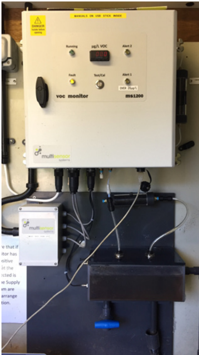
Figure 14. — Une photo de l'unité installée dans la dépendance. L'unité contrôle une vanne d'écluse qui détourne le débit du réservoir en cas de contamination
