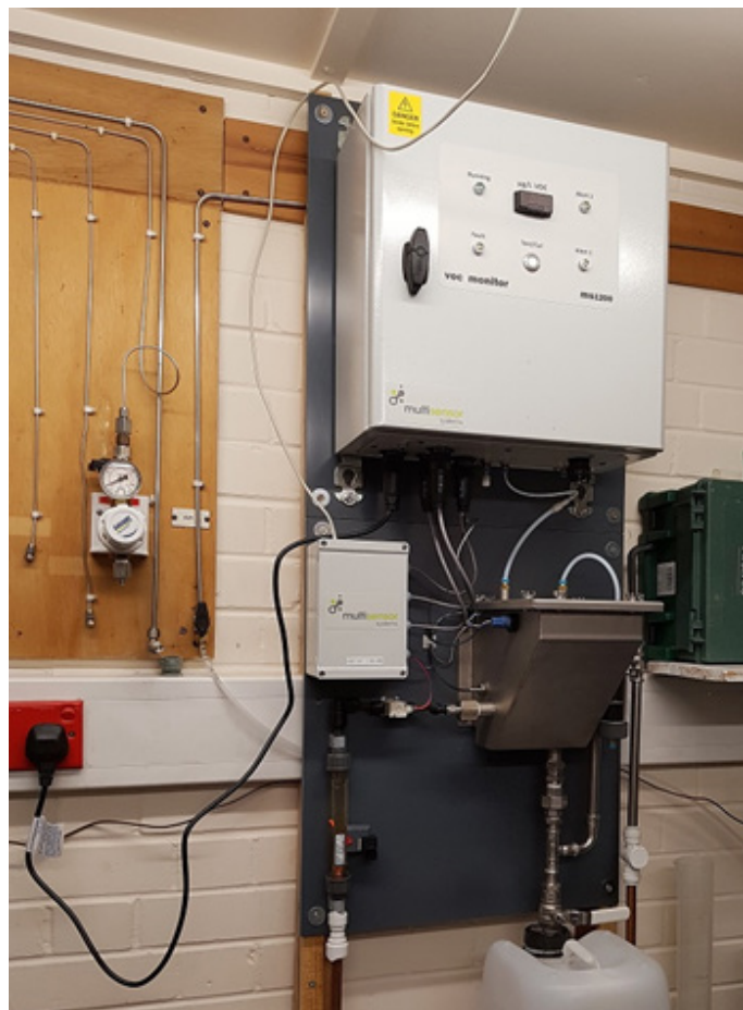
Figure 13. — Une photo de l'unité installée dans la dépendance. L'unité est connectée à un automate qui enregistre les données et, en cas d'accident, déclenche une alarme qui arrête les pompes d'admission.
