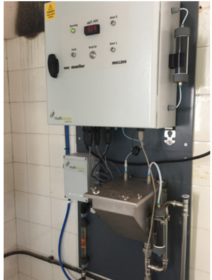
Figure 15. — Une photo de l'unité installée dans une dépendance à côté du forage.
