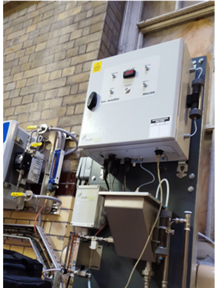
Figure 16. — MS1200 installé en 2014
